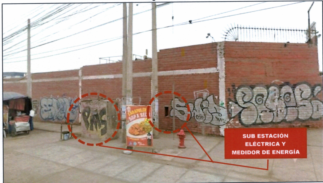
Subestación eléctrica y medidor de energía en el frontis del predio. Fuente: Trabajo de campo, 2026.
